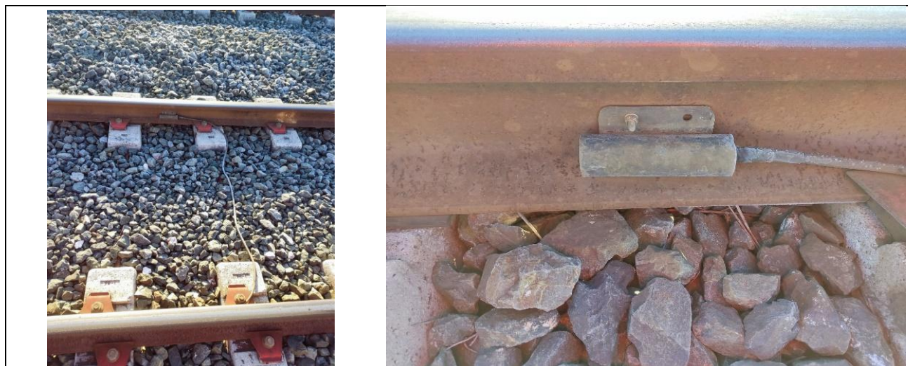
Εικόνα: Πυκνωτές Κυκλωμάτων Γραμμής- Φίλτρα αντιστάθμισης 30-32μF
