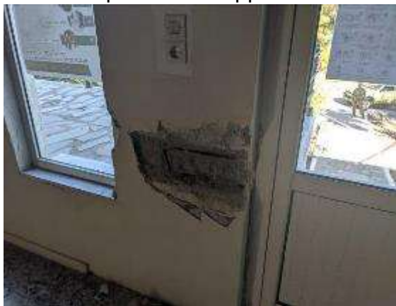
Ρηγμάτωση υποστυλώματος με αποδιοργάνωση Σκυροδέματος και αποκάλυψη οξειδωμένου οπλισμού.
