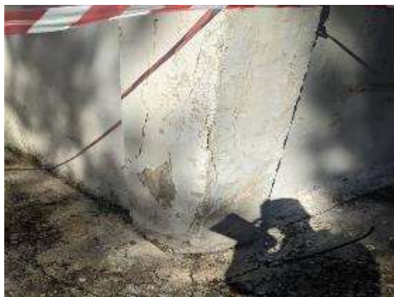
Ρωγμές σε εξωτερικό υποστύλωμα οπίσθιας όψης.
