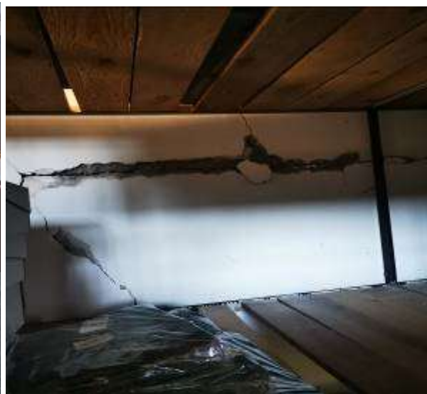
Ρωγμή Εσωτερικά του Κτιρίου επί της Τοιχοποιίας.
